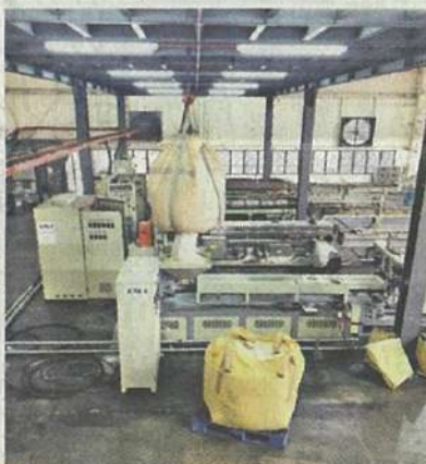
マレーシア工場の設備。押出機などがずらりと並び
